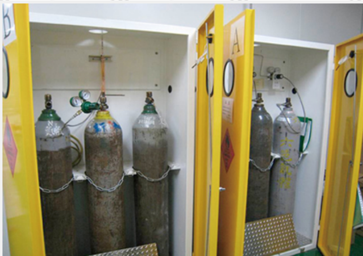
氣體鋼瓶櫃－氣體鋼瓶固定位置及防止傾倒，可降低火災爆炸危機！
