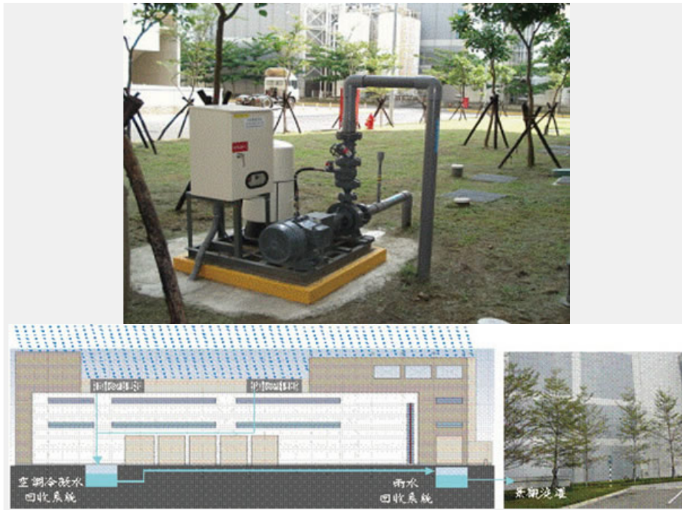
臺積南科廠區雨水回收系統
