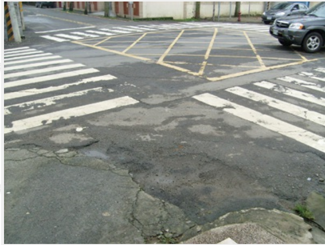
行人穿越道標線破損
